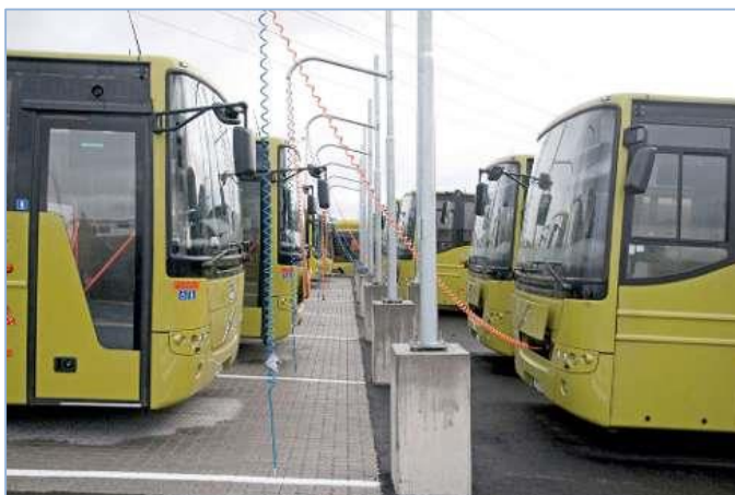
Fra bussplassene: Forsyningsanlegg og gangbane til bussene
