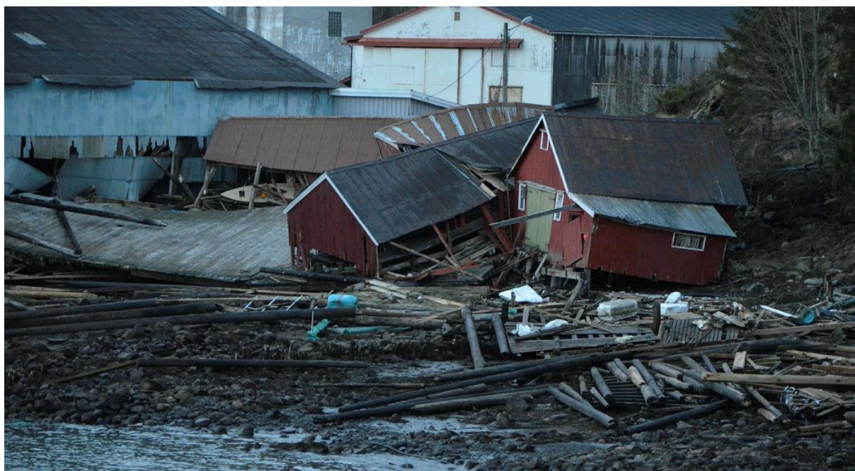
7 Nord-Statland i Namdalseid 2014. Ras med etterfølgende flodbølge førte til store skader. Foto: NTFK
